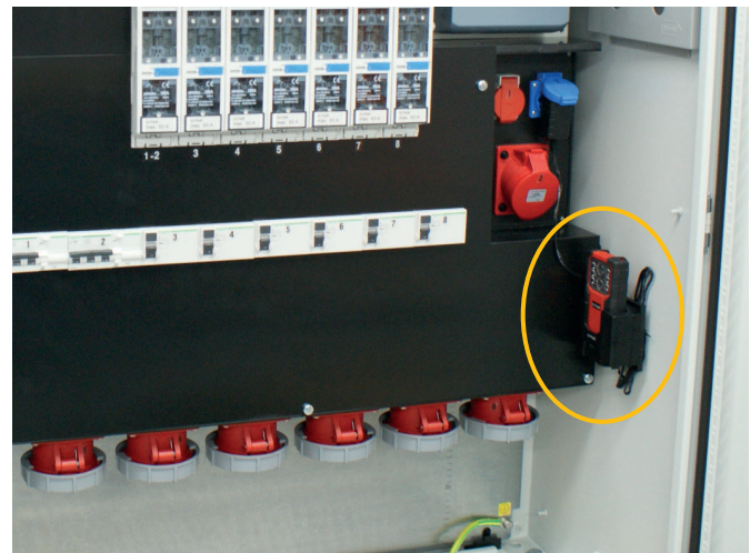
TorchLED de secours dans tableau de chantier
